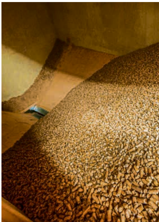
Auch das ist neu: Pelletheizung statt Ölheizung.
