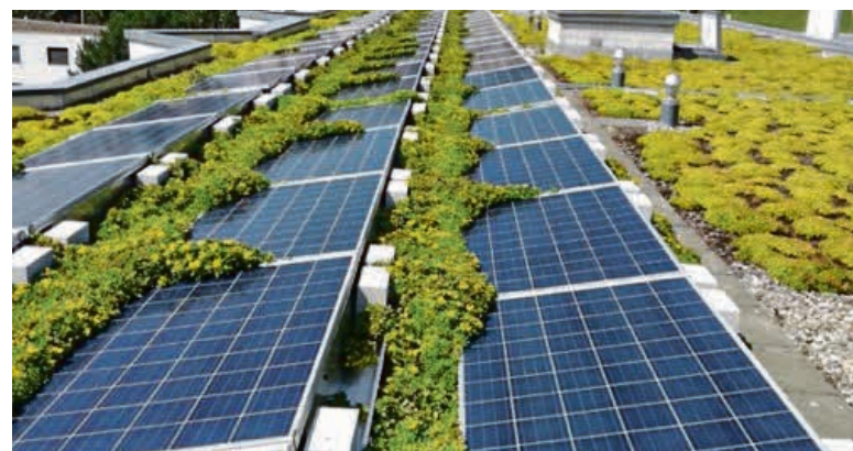
Bien qu'elles soient belles, elles nuisent au rendement énergétique des installations photovoltaïques : des plantes qui créent de l'ombre sur les panneaux solaires.
